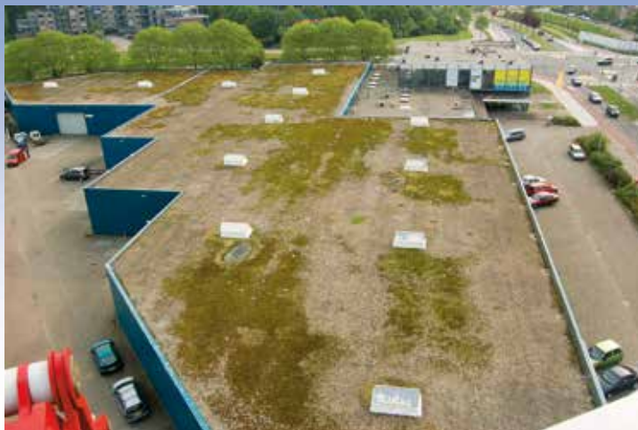
● Overzicht uit hoogwerker van de brandweer. Foto: Kees Roobeek.
