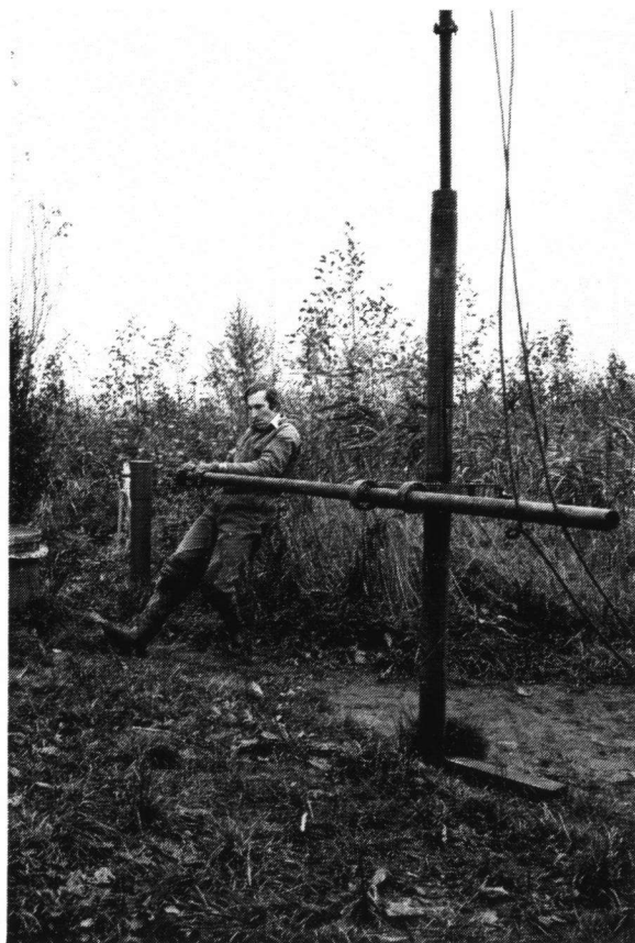
Fig. 2: De uitvoering van de boring Zuurland geschiedt uitsluitend met "dommekracht". Aan deze boring ligt dan ook zware lichamelijke arbeid ten grondslag. Foto: R.G. Meijer, 1987.
