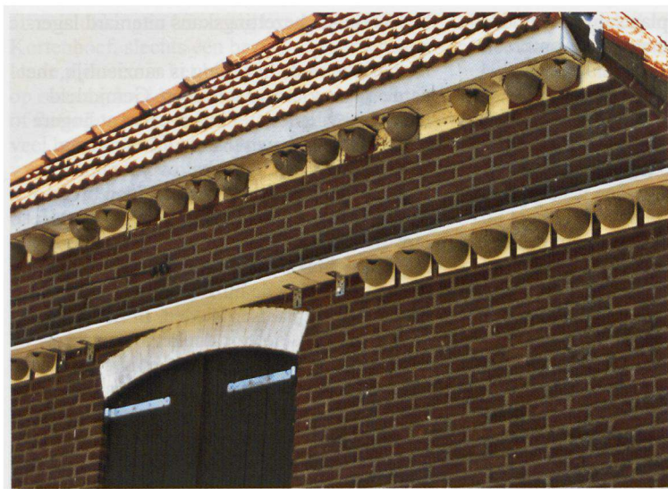
Etagewoningen voor Huiszwaluwen aan een schuur in Noordijk (Berkelland). Foto: Sonja Grooters.
