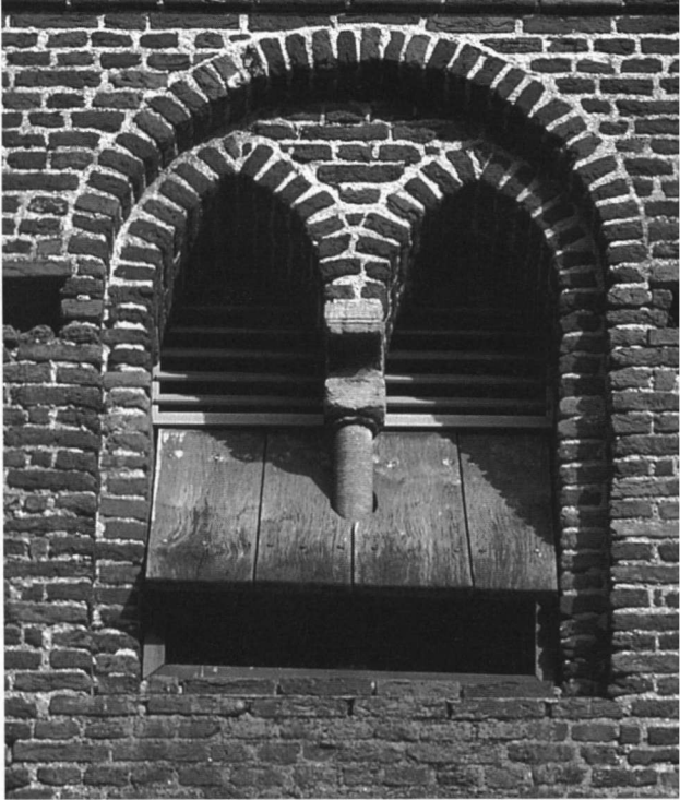
De toegankelijkheid voor vleermuizen van kerktorens kan worden verbeterd door gaas voor de galmgaten deels te vervangen door lamellen. Duiven en kauwen kunnen hier niet naar binnen, vleermuizen wel. Foto: Ben verboom
